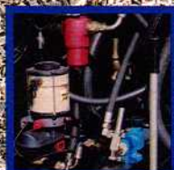
Impianto di lubrificazione centralizzata per la tenuta della macina
